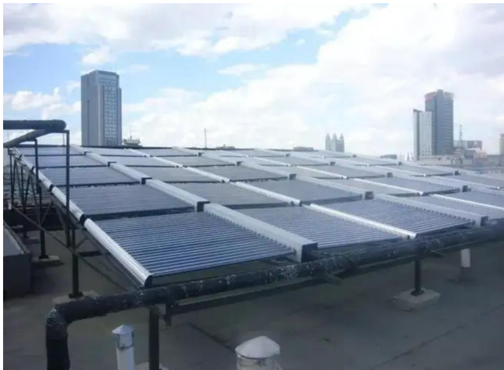
图 9.4-3 集中式太阳能热水屋顶敷设实景图
